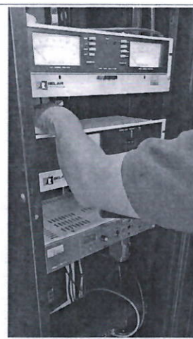
Limpieza de equipos estudio-planta y monitores de modulación, calibración de recepción y salida de audio.
