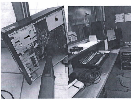
Limpieza de CPUs de computadoras, y del rack de equipos en mesa de transmisión.
